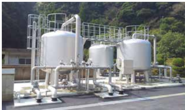
熊本県天草郡苓北町笹尾浄水場 (鉄・マンガン・濁度除去圧力式急速ろ過機)
